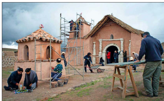
ARICA.— Un total de 16 iglesias andinas han sido restauradas en el extremo norte por la Fundación Altiplano. Para las obras han contado tanto con fondos públicos como con recursos privados.
