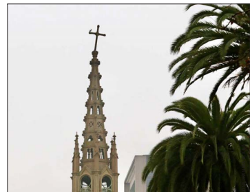
VIÑA DEL MAR.— Recientes sismos generaron riesgo de caída de la cruz de la parroquia Virgen del Carmen.
