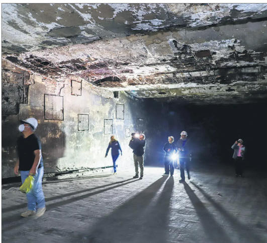
Así está hoy el subterráneo del edificio, donde se inició el fuego.
