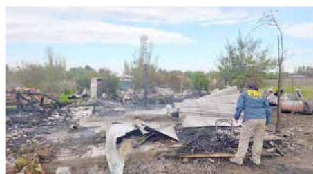
El fuego rápidamente redujo a cenizas el inmueble de material ligero (Linares en Línea).
